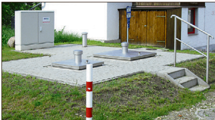
Die Druckerhöhungsstation (DE) Taubendorf wurde von 2011 bis 2012 als Teilprojekt der Maßnahme „Ersatz Wasserwerk Taubendorf“ in unterirdischer Bauweise errichtet. Die Anlage versorgt Albertinenäue (Schenkendöbern, OT Groß Gastrose) sowie Griefzen mit Trinkwasser. Die maximal ausspeisbare Menge liegt bei ca. 50 m³/h, der Betriebsdruck am Ausgang der DE bei 6,7 bar. Im Ortsnetz Griefzen liegt der Druck je nach Standort bei ca. 3,5 bar.
