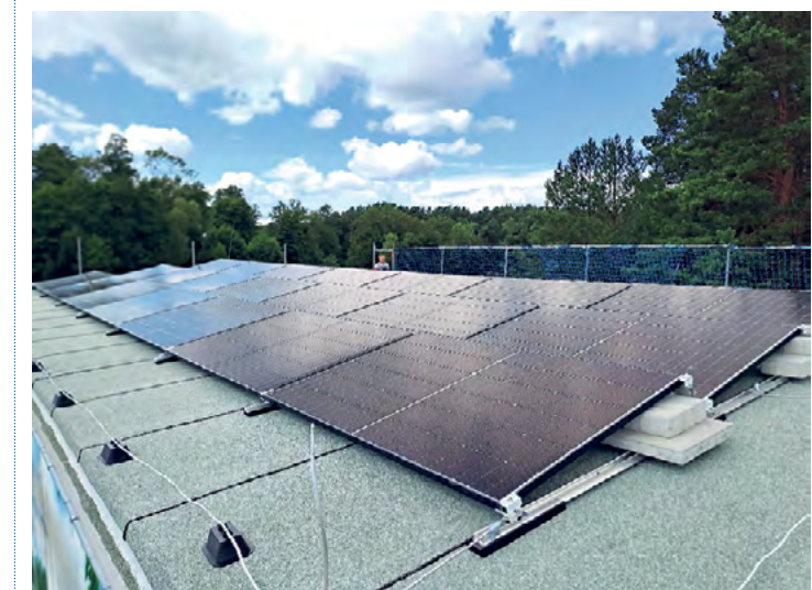
Auf dem Dach des Wasserwerkes befindet sich die jüngste Photovoltaikanlage des GWAZ.
