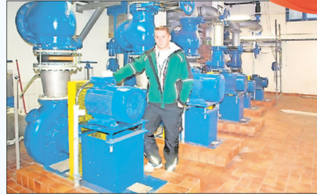
Enrico Forch, Teamleiter Abwasser, im Hauptpumpwerk Guben. Von hier aus werden die Abwässer auf die moderne Kläranlage in Gubin gepumpt und dort gereinigt. Foto: SPREE-PR/Kuhn
