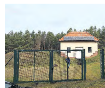
Sanierungsbedürftig sind ebenfalls die beiden Trinkwasserbehälter auf dem Eichberg bei Lieberose.
