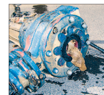
Diese Pumpe ist hoffnungslos verstopft.
