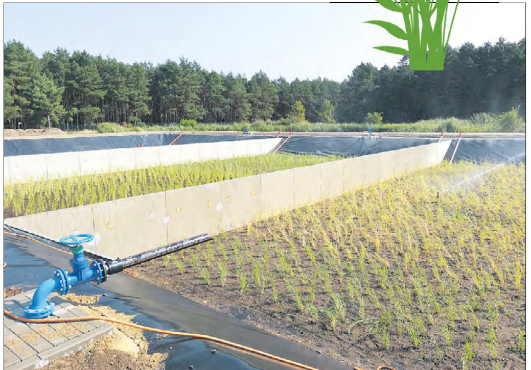
Auf der Oberbodenschicht werden Schilfbeete angelegt. Die Pflanzen sind optimal, um den Schlamm mit Sauerstoff zu durchlüften.
