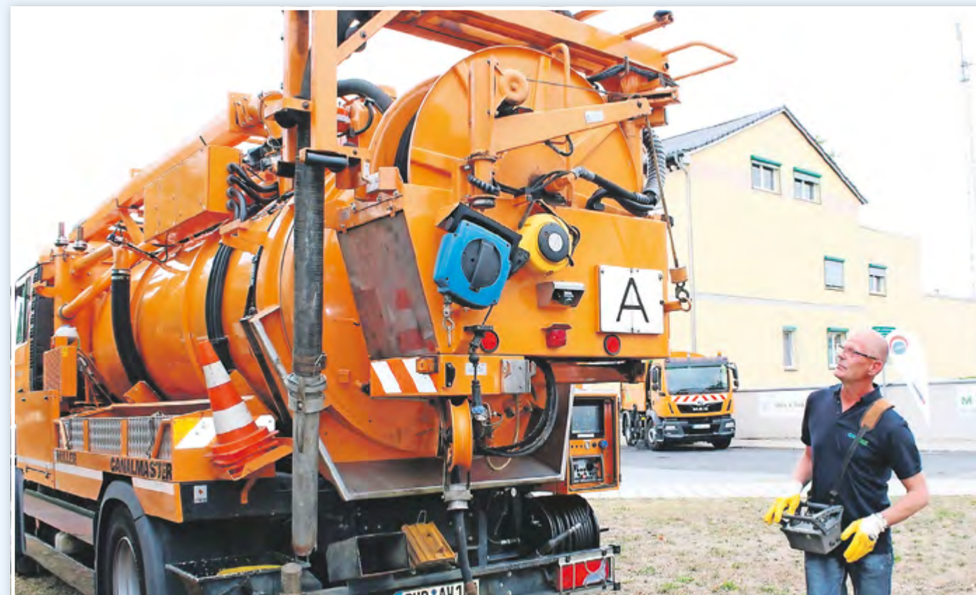
André Reichelt vom Abwasserteam des GWAZ ist mit seinem Spezialfahrzeug im Verbandsgebiet unterwegs, um das Kanalnetz zu reinigen. Per Fernbedienung lassen sich u.a. die Saug- und Spülvorgänge steuern. Ab Januar 2020 vergrößert sich das Team Abwasser. Sowohl neue Mitarbeiter als auch neue Fahrzeuge werden für die Fäkalienentsorgung benötigt.
