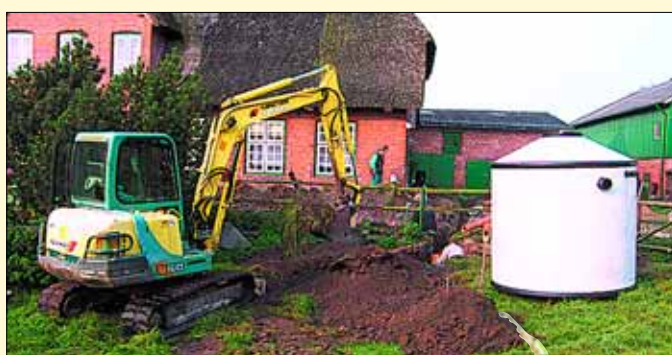
Aushub einer Grube für eine Kleinkläranlage. Bei richtiger Funktionsweise machen Flora und Fauna Freudensprünge.
