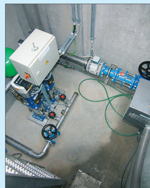
Die Druckerhöhungsstation Pinnow – eine ähnliche Anlage wird im Jahr 2007 in Lauschwitz gebaut.
